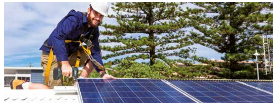
Die Installation von Solarmodulen auf dem Dach ermöglicht die energieeffiziente Nutzung der Sonne um Ihr E-Bike oder Elektroauto zu laden.
